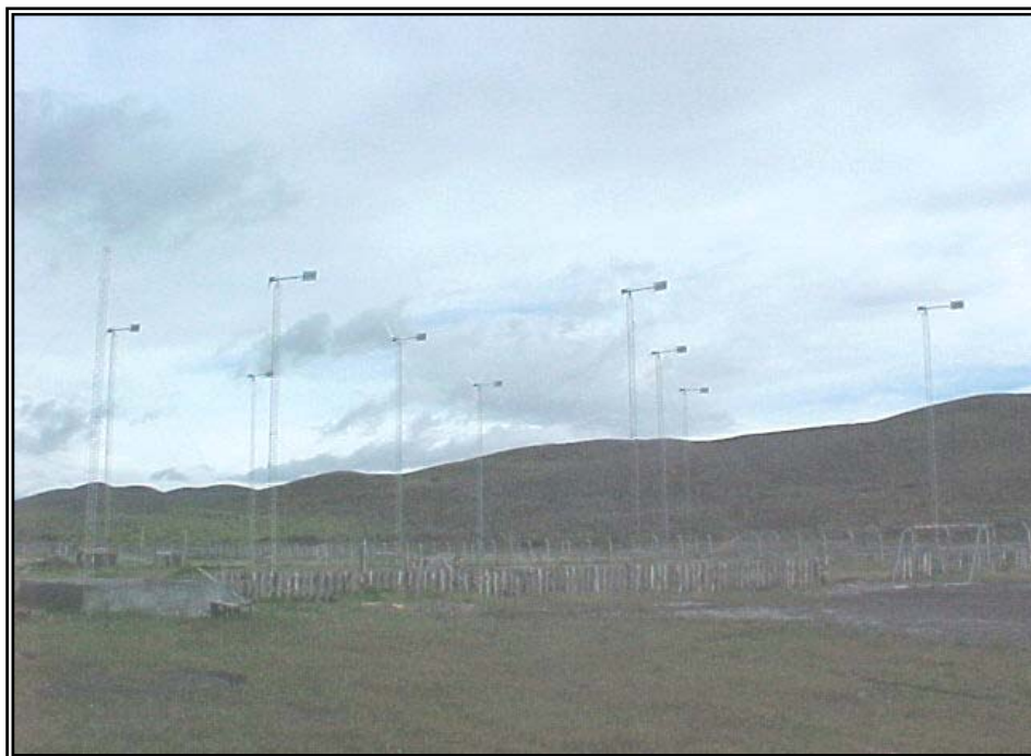
Parque eólico aldea escolar Colonia Cushamen - registro propio.
